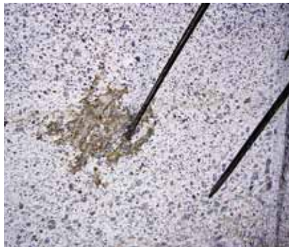
▲ Betonipinnan kuntoa voi tarkistaa raappamalla valupintaa teräspiikillä. Siilossa seinämien alaosat syöpyvät pahiten.
