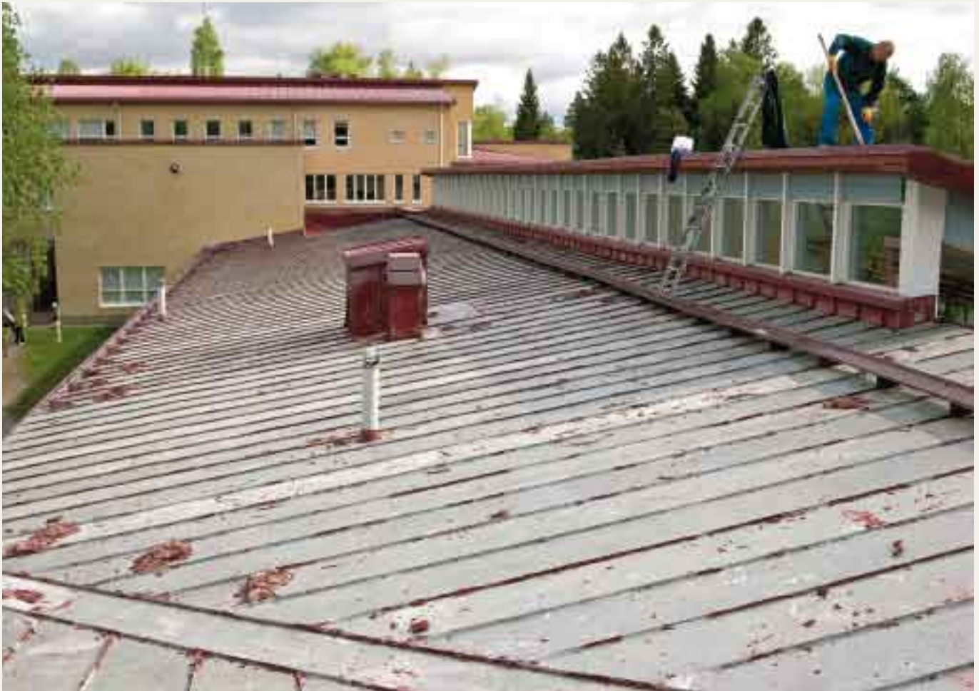
Maalinpoistoaineella käsiteltävää pintaa oli kohteessa kaikkiaan noin 4500 neliötä. Kuvauspäivänä kirjastosiiven maalinpoistotyöt olivat jo melkein tehty ja taustalla näkyvä koulurakennus odotti vuoroaan.
